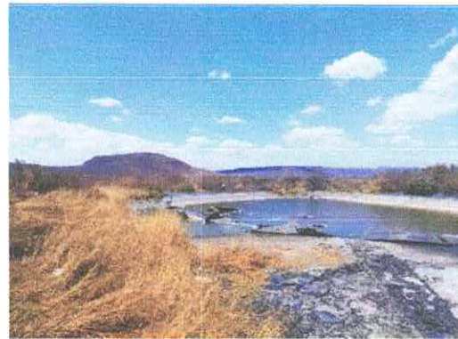
Geomembrana fosa lixiviados afectada por fuego
